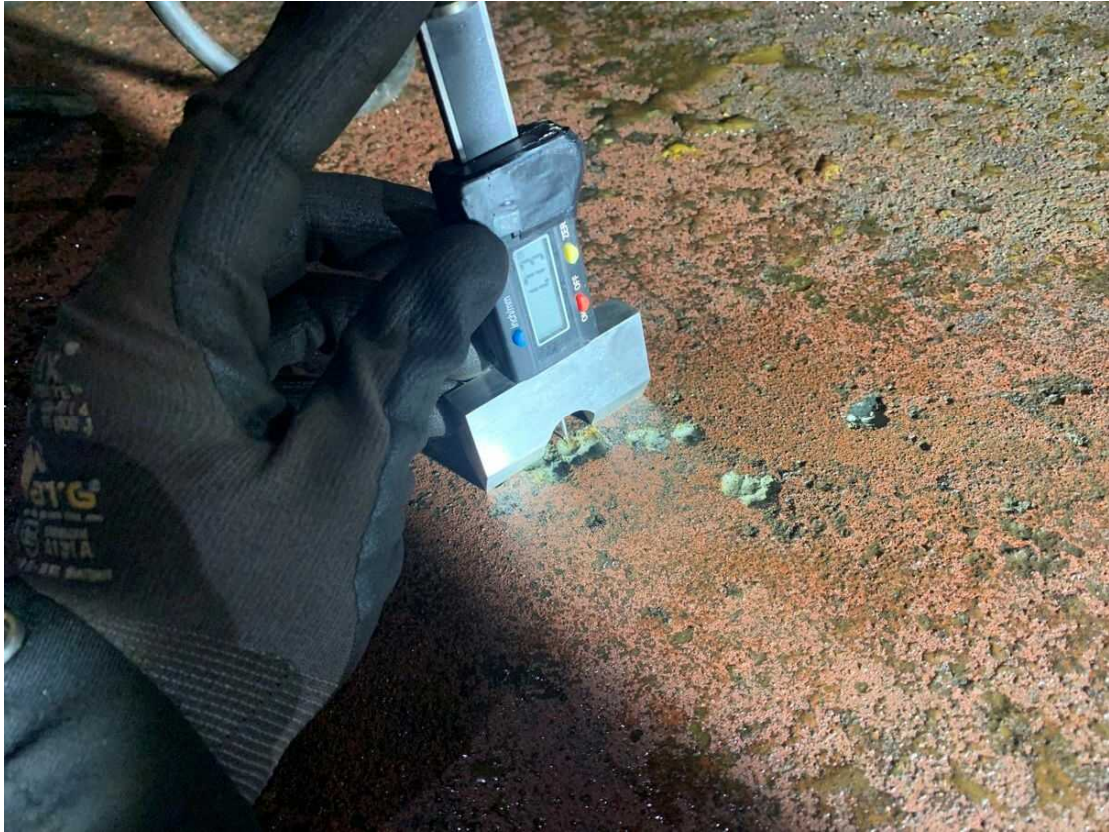
Mynd 8. Gólf er alsett tæringu. Á einstaka stöðum má finna pytti allt að 1,5 – 2,4 mm dýpt
