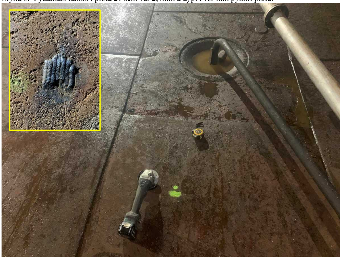
Mynd 4. Gólfskanni gaf tilkynna tæringu í plötu 17, rafsoðnir voru nokkrir strengir yfir svæðið. Mynd 5. Innfæld mynd af viðgerð. Mynd sýnir einnig ágætlega ástand gólfs.
