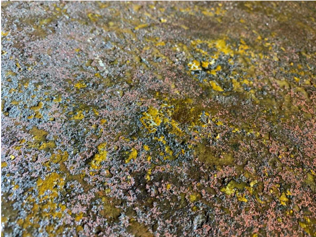
Mynd 7. Gólf er alsett tæringu en þó ekki alvarlegri.
